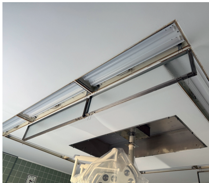
Abbildung 5: Passgenaue LED-Module fanden ihren Platz in den bereits vorhandenen Gehäusen der OP-Säle.
